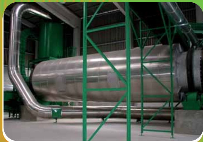
Eine große, sich drehende Trommel, die ähnlich funktioniert wie eine Heizung, trocknet die Abfälle
