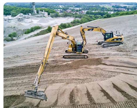
Für eigene Deponien hat der Unternehmensverbund Nachsorgeverpflichtungen. Das Nachsorgegutachten gibt vor, wieviel Geld für die Zukunft zurückgelegt werden muss, um nachfolgenden Generationen keine Vergangenheitskosten aufzubürden.
