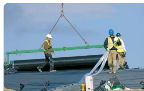
Die einzelnen Abschnitte der Kunststoffdichtungsbahn werden miteinander verschweißt, so dass ein wasserdichter Deckel für den Deponieabschnitt entsteht.
