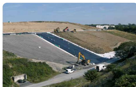
Auf die Ausgleichsschicht (grau) folgen die Bentonitmatte (weiß), die Kunststoffdichtungsbahn (schwarz), die Drainagematte (weiß) und die Rekultivierungsschicht aus Boden.
